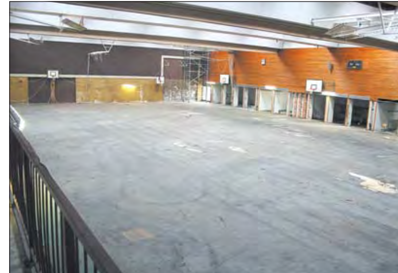
Im Sommer, wahrscheinlich im Monat Juni, wird die OPG-Halle in Lippinghausen abgerissen. Die Fertigstellung der neuen Sportstätte ist für August 2014 vorgesehen. Fotos: Curd Paetzke/Kathrin Brinkmann
